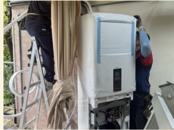
家園冷氣裝設
